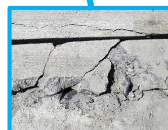
隅角部ひび割れ
