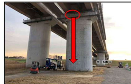
橋梁の下部工検査路設置作業中、作業員1名が転落し死亡が確認された事案
