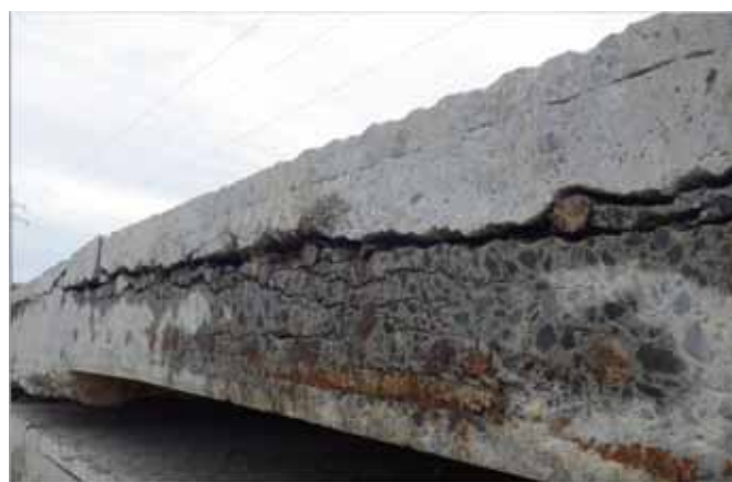
出典：道路構造物ジャーナルNET 東日本高速道路 維持管理リレー連載① 高速道路における橋梁の劣化と維持管理の課題を考える
