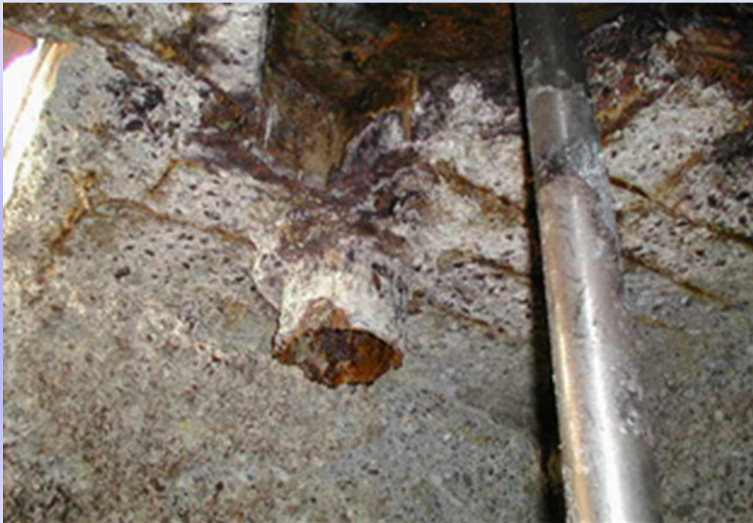
汚泥濃縮槽（鉄筋も消失）
