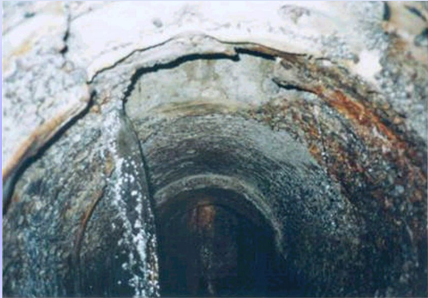
下水管路：上部からの漏水
