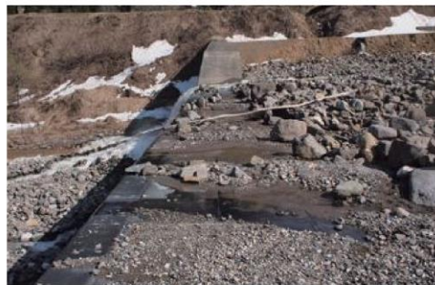
▲ラバーSteel設置状況 (平均摩耗速度0.26mm/年、経過年数18年時)
