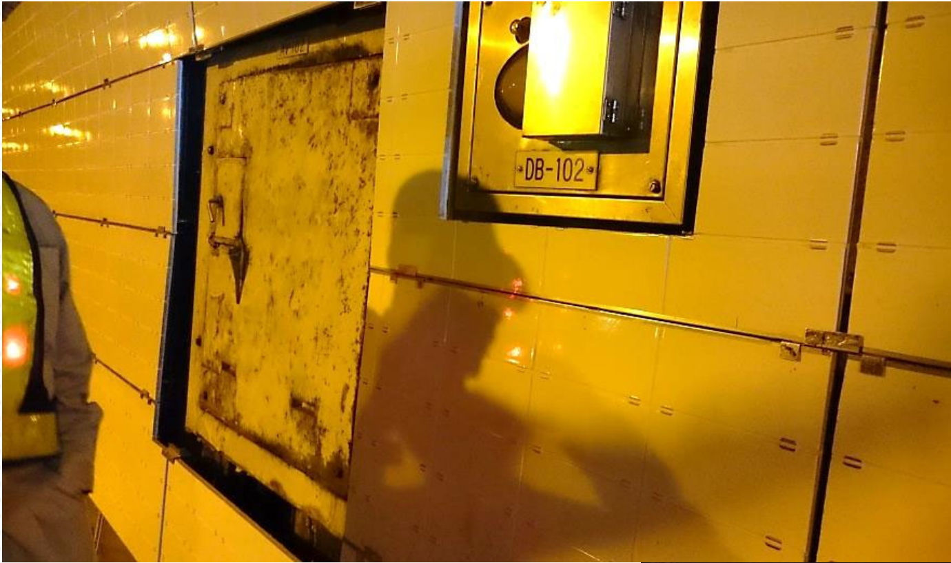
▲秋田 仙岩トンネル 裏面に地下水が流れている
