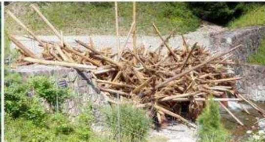
流木捕捉工(兵庫県宍粟市)
