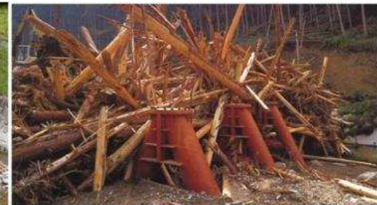
流木捕捉工(大分県中津市)
