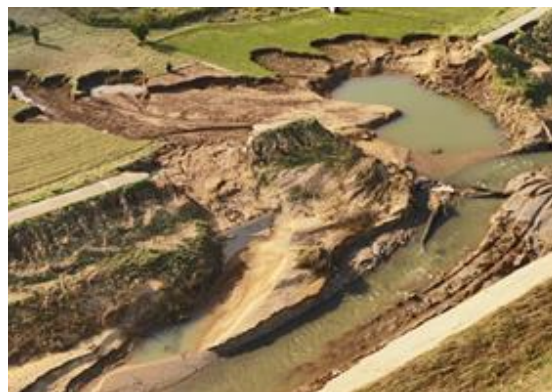
河川の被災状況調査 (茨城県常陸太田市[浅川])
