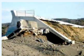
越流による堤防の被災
