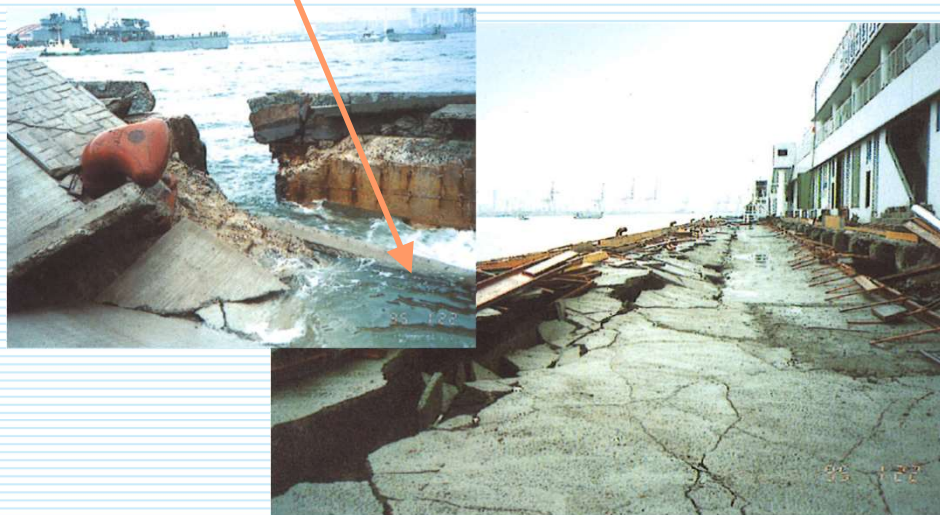
建物周辺の未改良箇所の被害
