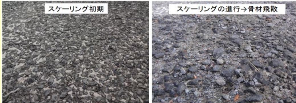
半たわみ性舗装の凍結融解によるスケーリング損傷
