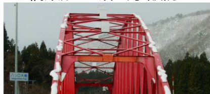
橋梁からの落雪事故防止
