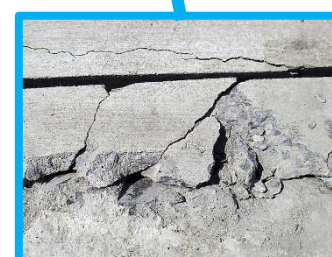
隅角部ひび割れ
