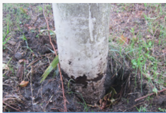
倒壊の原因となる腐食(錆)
