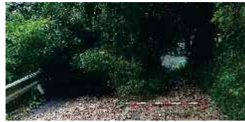
大多喜町での道路寸断状況
