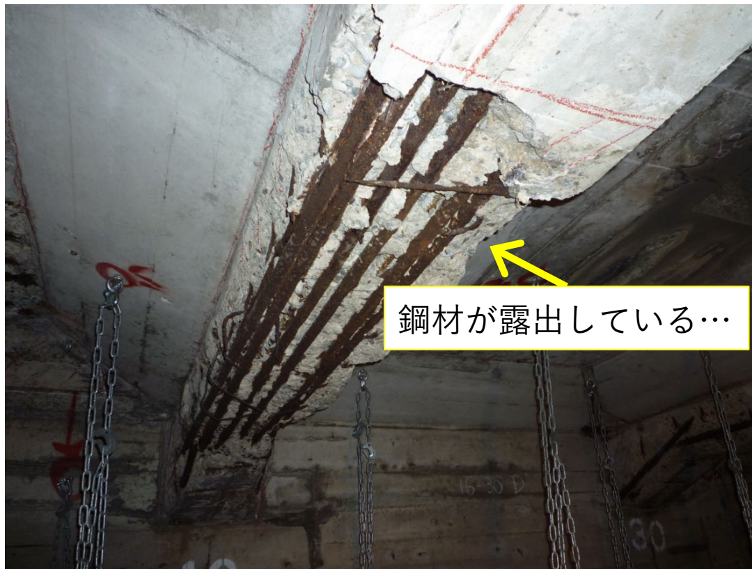
コンクリート構造物の塩害劣化
