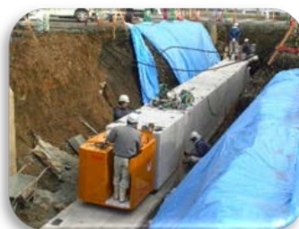
据え付け状況
