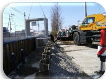
据え付け状況
