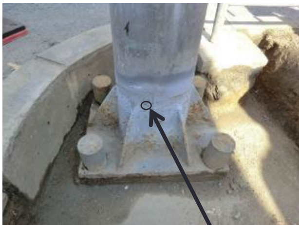
ケレン時に発生した貫通孔食
