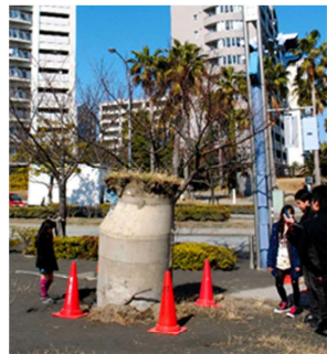
マンホールの 浮き上がり状況
