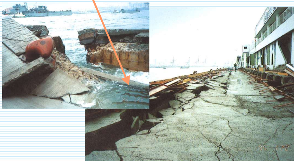
建物周辺の未改良箇所の被害
