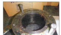
ポンプ軸受内径側に摩耗痕
