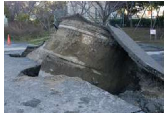
液状化でマンホールが飛び出した道路（船橋市）
