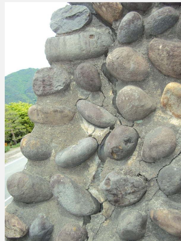
亀裂発生状況
