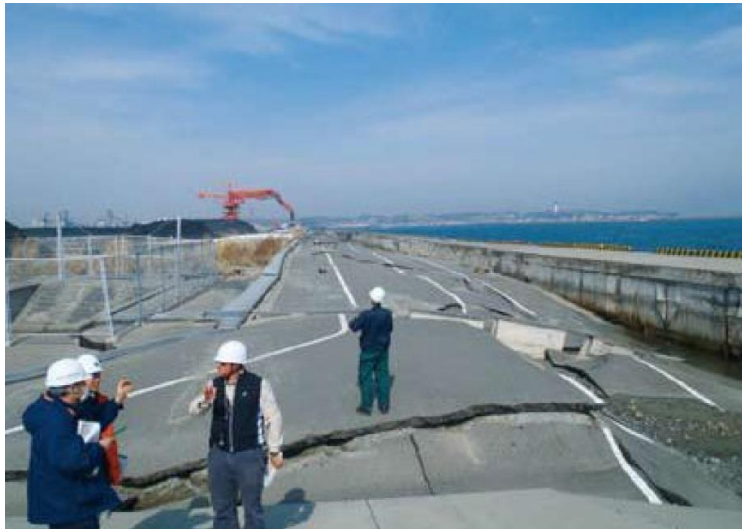
地震による液状化
