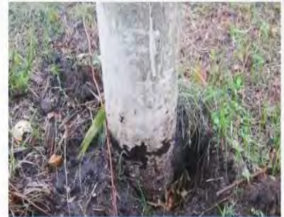
倒壊の原因となる腐食(錆)
