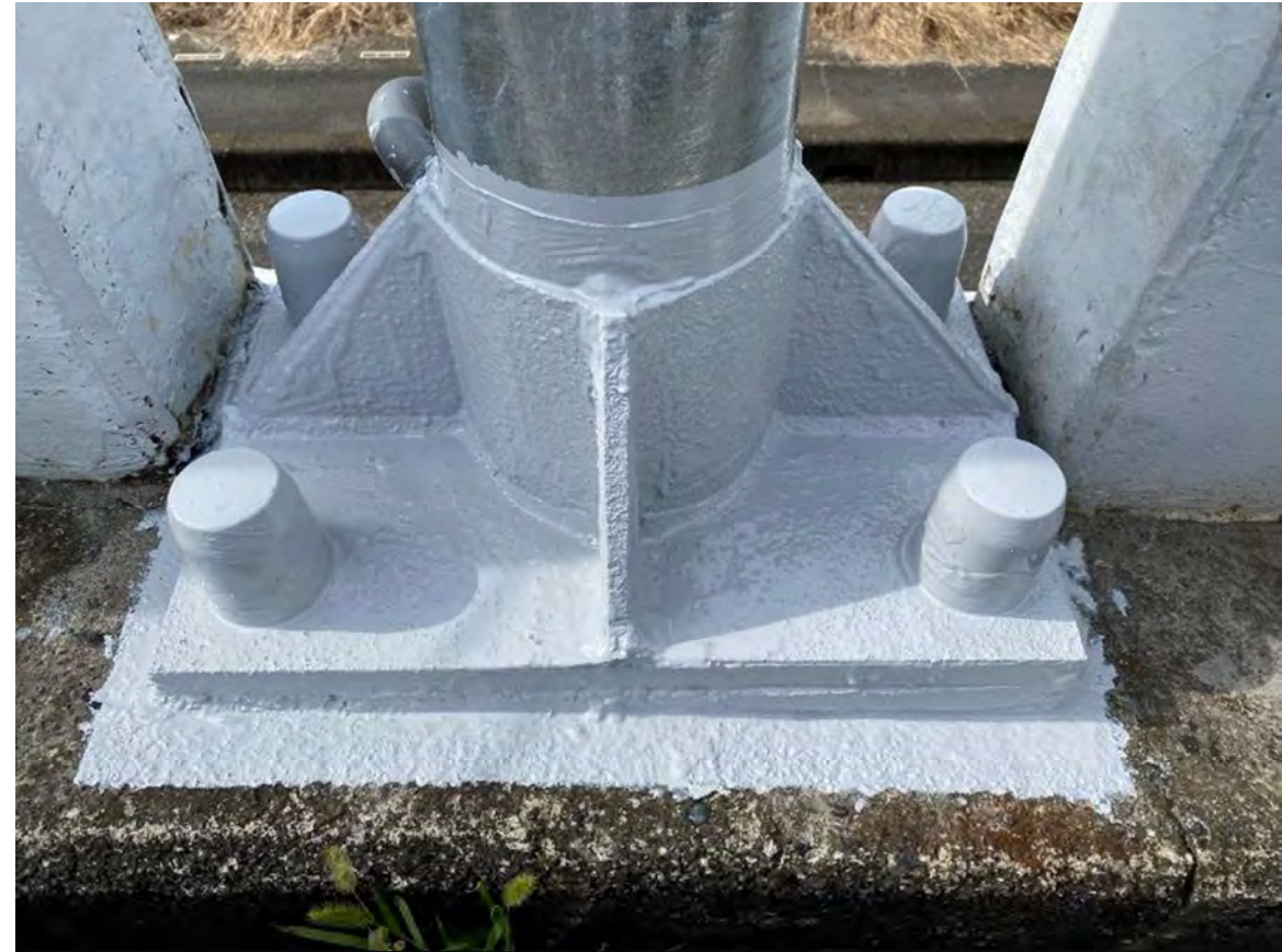
埼玉県 国道 道路照明柱 2021年施工
