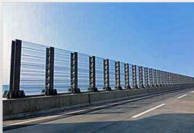
⑤透光防波柵 (波浪時に破損)
