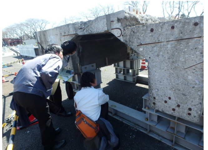
床版下の遊離石灰、コンクリート剥離の確認
